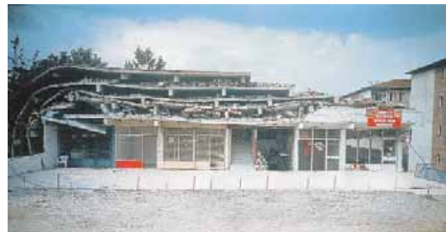
Gebäude mit «weichen» Obergeschossen (Ismit Türkei 1999, aus [5])
