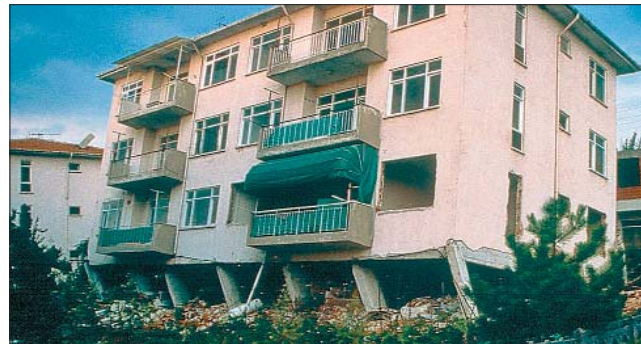
Gebäude mit «weichem» Erdgeschoss (Izmit Türkei 1999)
